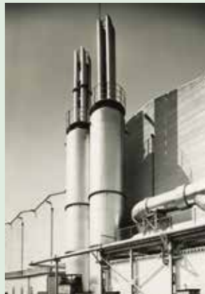
騒音防止のため設置された2基の大型サイレンサー
