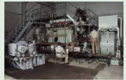
研究実験棟には3気筒の実験機関が据え付けられた。
